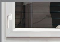
Poignée abaissée conforme à la norme PMR
