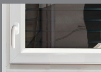
Poignée abaissée conforme à la norme PMR
